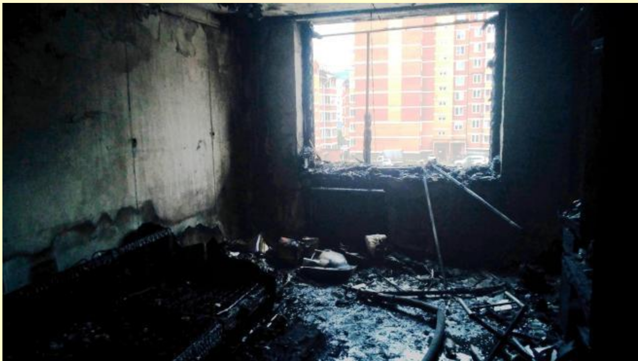
Пожар, произошедший 16.09.2017 г. по адресу: г. Сосновоборск, ул. Весенняя д.4.
