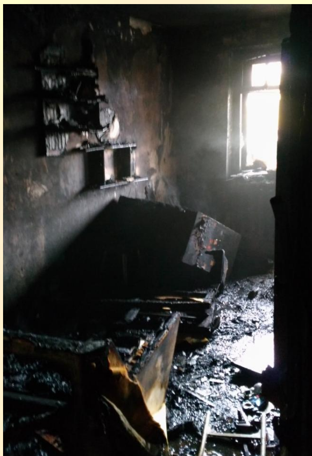
Пожар, произошедший 20.09.2017 г. по адресу: г. Сосновоборск, ул. 9-Пятилетки 28.
