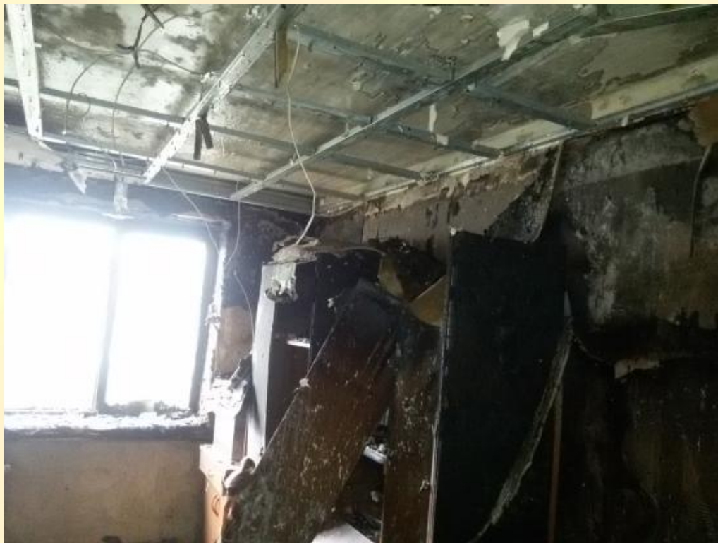
Пожар, произошедший 05.08.2017 г. по адресу: г. Сосновоборск, ул. 9 Пятилетки 28, поджог.
