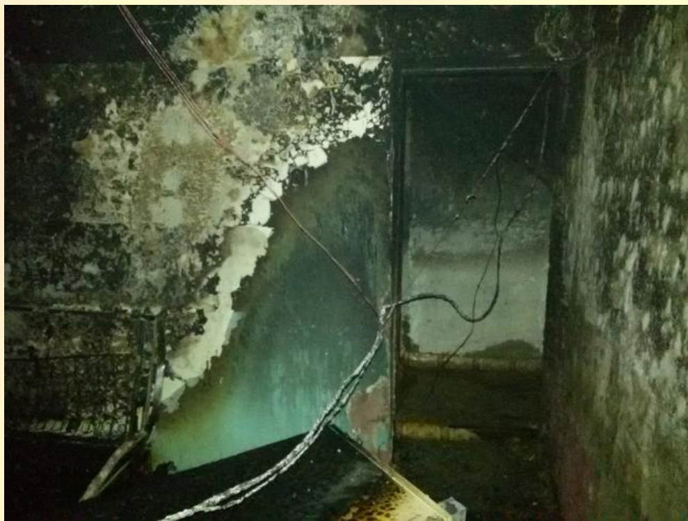
Пожар, произошедший 06.08.2017 г. по адресу: г. Сосновоборск, ул. Юности 5, поджог.
